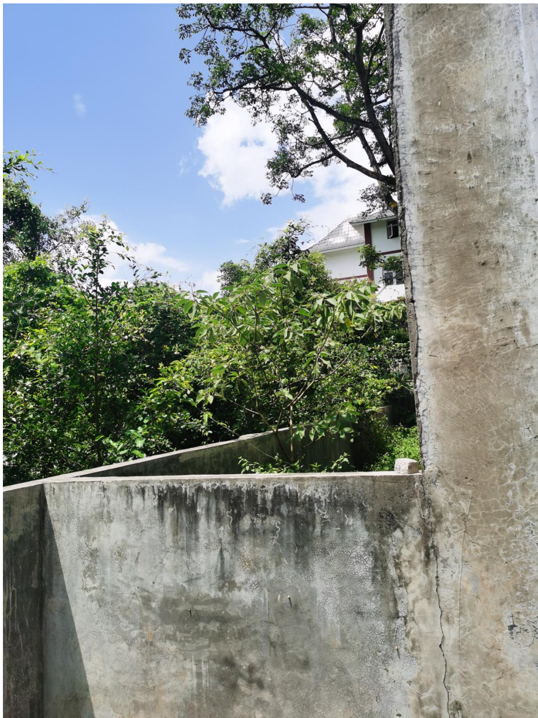
附图 1 事故应急池
